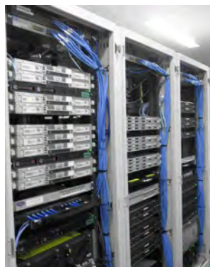
図 4.12: コンピュータ室
