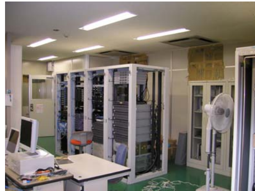
図 4.11: コンピュータ室
