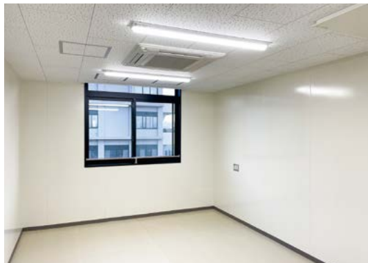
LED 照明、高効率空調機、断熱材（外壁内側） （2025 年度（本庄町 1）理工学部理系大学院棟）
