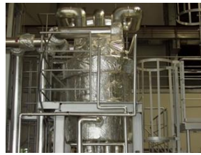
海水淡水化実験装置
