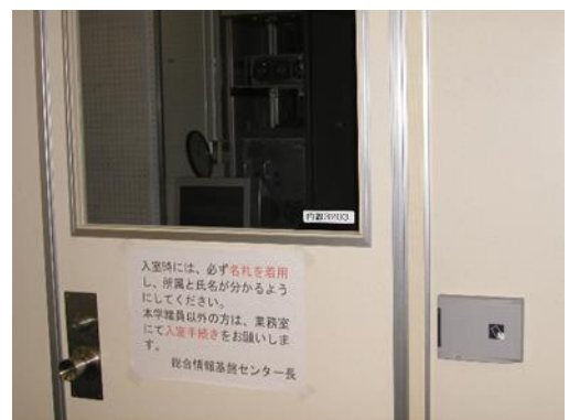
図 4.6 コンピュータ室入口の入退室管理
