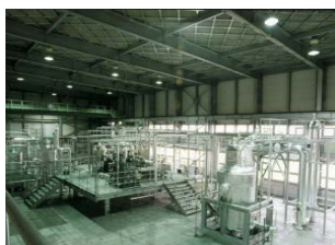
海洋温度差発電実験装置
