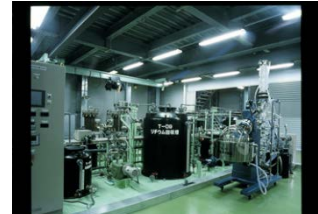
リチウム回収装置
