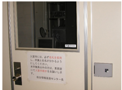
図 4.6 コンピュータ室入口の入退室管理
