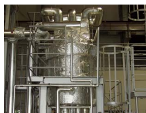
海水淡水化実験装置
