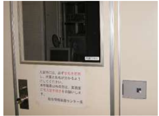
図 4.6 コンピュータ室入口の入退室管理
