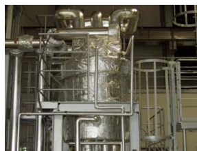
海水淡水化実験装置
