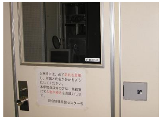
図 4.6 コンピュータ室入口の入退室管理
