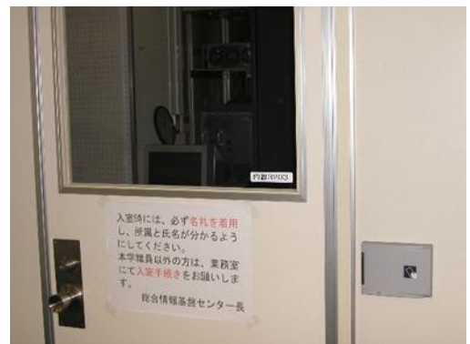
図 4.6 コンピュータ室入口の入退室管理
