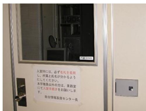
図 4.6 コンピュータ室入口の入退室管理
